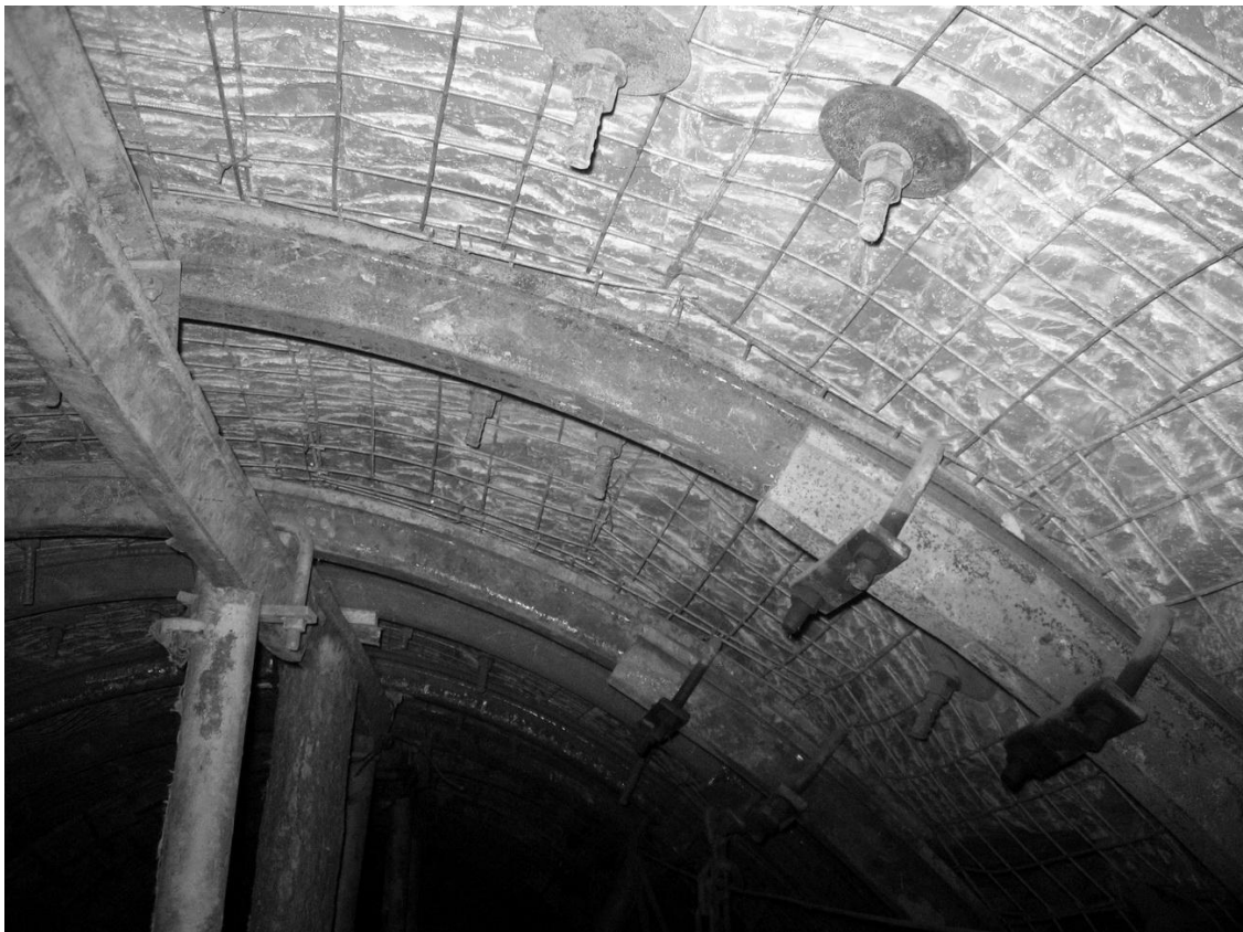
Рис. 4 – Стан покрівлі у 413 бортового штреку в 30 м за лінією очисного вибою
