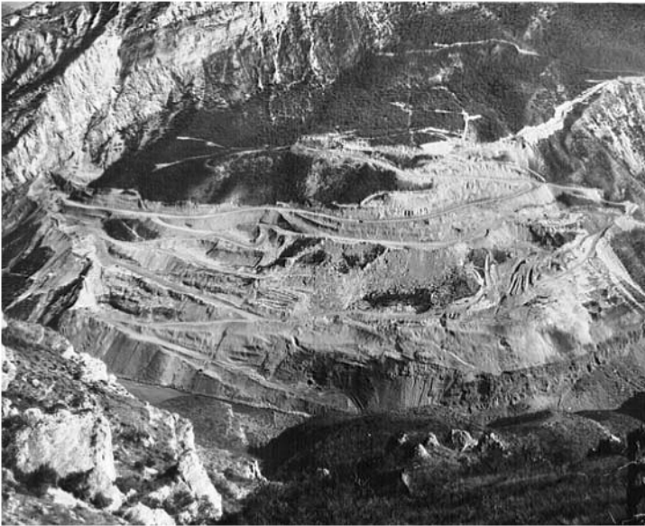
Рис. 2. Роботи по ліквідації зсуву, що виконувалися на початковій стадії будівництва Міатлінського гідровузла на р. Сулак в Росії (Роботи по стабілізації схилу в районі майбутнього водосховища тривали більше 8 років).
