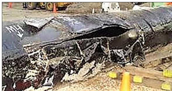
Рис. 2. Випадок руйнування магістрального газопроводу тривалої експлуатації через корозійне розтріскування
