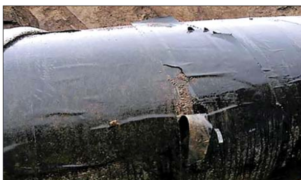
Рис. 3. Відшарування стрічкового захисного покриття, яке сталося під час експлуатації труб магістрального газопроводу
