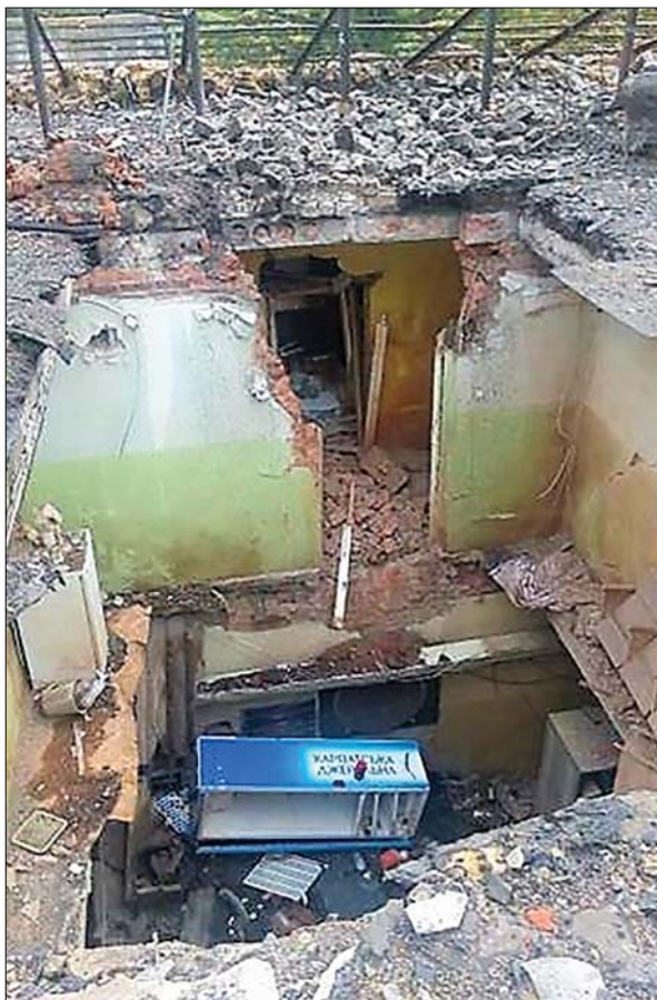
Руйнування центральної будівлі УТР-2
