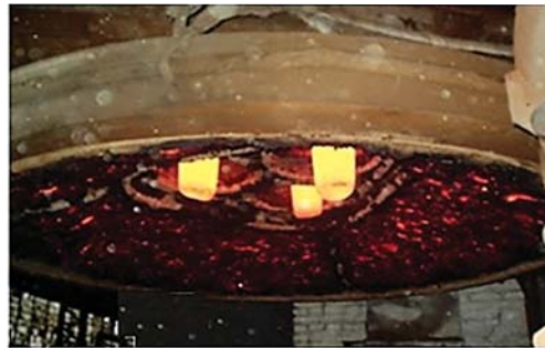
Рис. 10. Комбінований звід ДСП ливарного класу — загальне рішення (а) та реалізація (б): 1 — портал печі; 2 — опорне кільце зводу; 3 — центральна водоохолоджувана частина; 4 — опори; 5 — витяжний газохід; 6 — вогнетривка вставка
