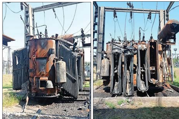
Рис. 1. Зруйнований електротрансформатор ТЕЦ потужність 40 МВт в одному з обласних центрів України. Весна 2022 р. (фото Б.І. Баска)
