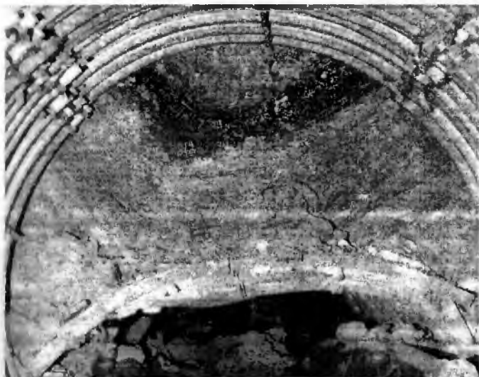
Рис. 1. Вид породной складки в кровле полевого откаточного штрека гор. 380м шахты Западно-Донбасская
