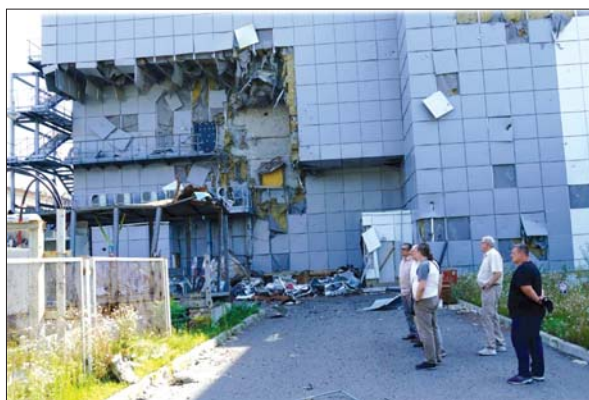
Делегація Президії НАН України оглядає пошкоджену будівлю установки «Джерело нейтронів»
