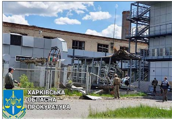
Подвір'я будівлі ядерної підкритичної установки «Джерело нейтронів» після обстрілу 6 березня 2022 р.
