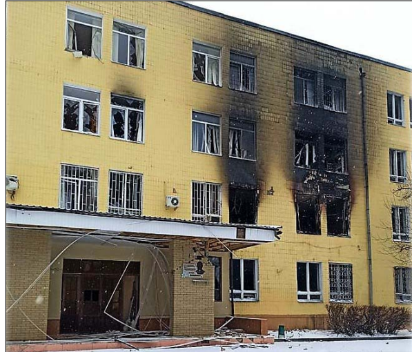
Пошкодження корпусу фізико-технічного факультету Харківського національного університету ім. В.Н. Каразіна після боїв 25 лютого 2022 р.
