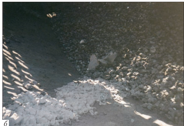
Рис. 2. Пошкодження сталевих бункерів для зберігання рудного агломерату: a — розриви ребер жорсткості; б — руйнування футерівки
