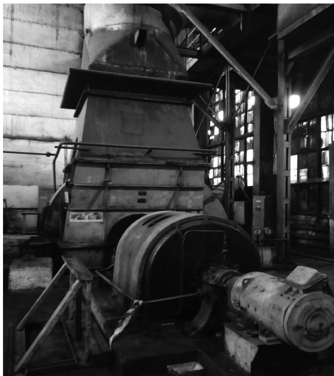
Рис. 3. Эксгаустер 3500-15-1, обеспечивающий транспортировку по магистральным газоходам газоотводящих трактов (ЭРТУМГ) потоков очищающегося и очищенного газов
