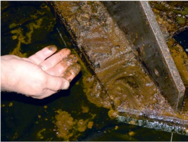
Фото 1. Загрязнение нижней ярмовой балки.
