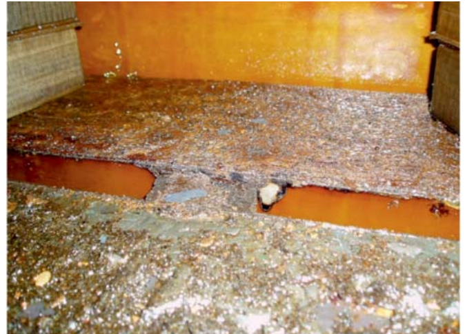
Фото 2. Следы подгара магнитопровода.
