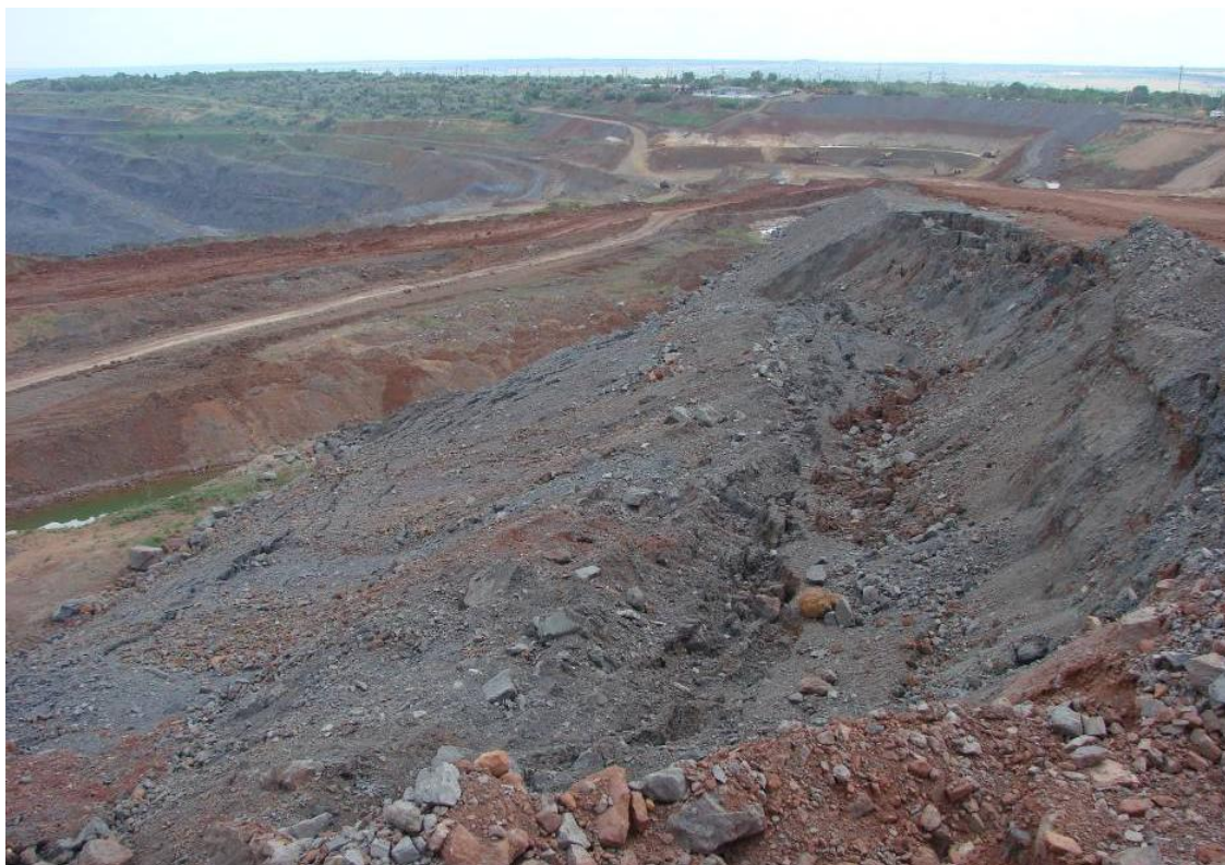
Рисунок 1 - Оползень насыпи конвейерного тракта
