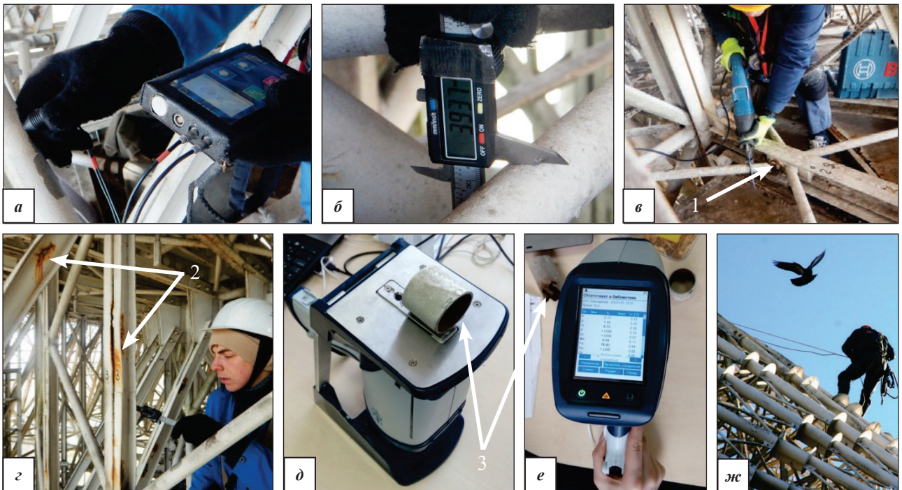
Выявление дефектных элементов конструкций (а–ж) на этапе инструментального обследования: 1 – разрыв несущего элемента; 2 – скрытая коррозия элементов; 3 – марка стали не соответствует требованиям действующих норм проектирования
