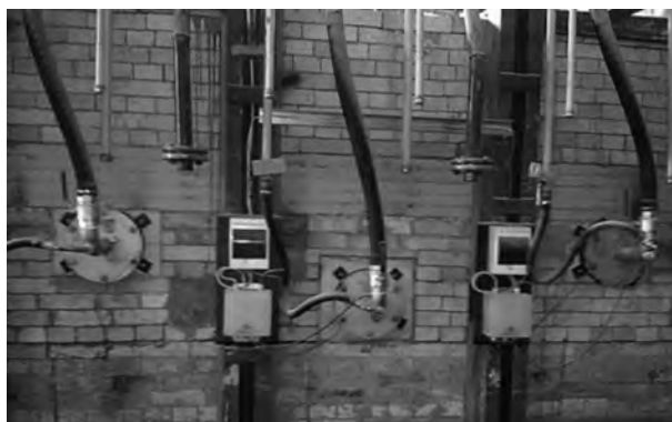
Рис.4. Расположение горелок ГНБ-80 и блоков управления ТК1301.03 на боковой стене печи.
