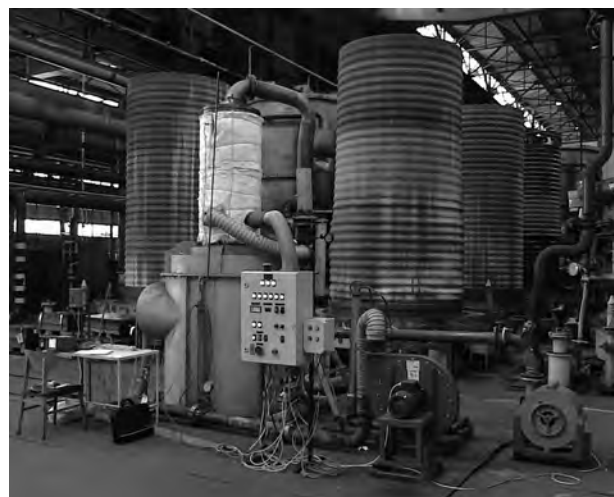
Рис.11. Общий вид опытной печи для испытаний рекуператора RRD, смонтированной в цехе холодной прокатки металлургического комбината «ISD DUNAFERR» (на переднем плане).
