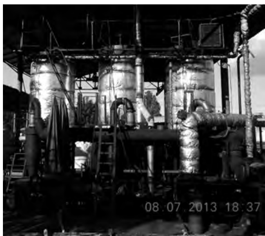
Рис.3. Газогенераторный комплекс мощностью 1,8 МВт на базе газогенераторов обращенного процесса.
