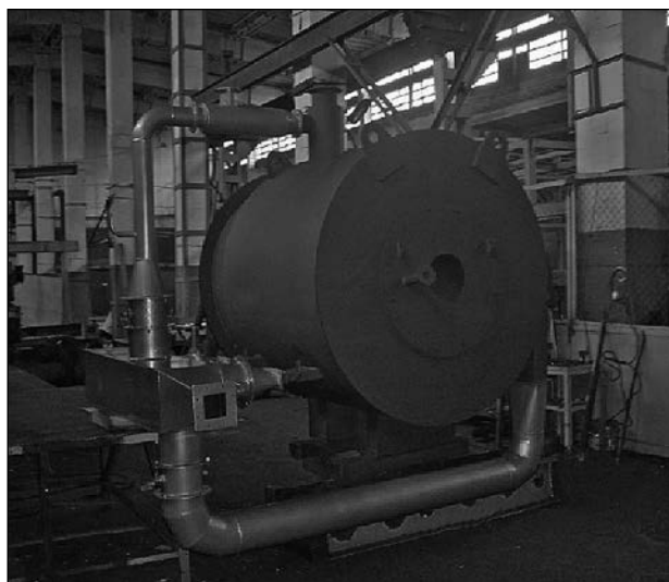
Рис. 6. Зовнішній вигляд горизонтального пальника для спалювання відходів деревини як резервного палива в топці котла ДКВР 2,5
