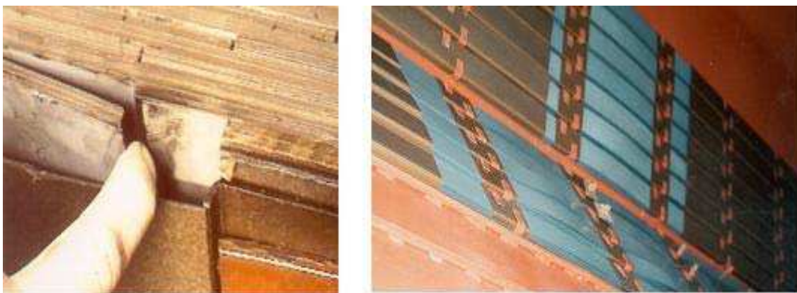
Рис. 5. Следы перегрева шунта в месте стыка (слева)
