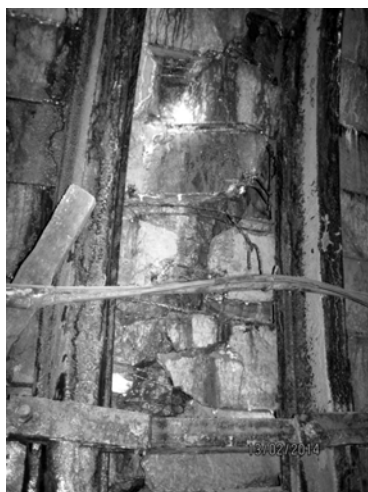
Рис. 5. Деформация межрядных затяжек
