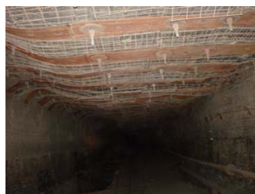
Рис. 5. Состояние кровли 157-го штрека шахты «Степная»
