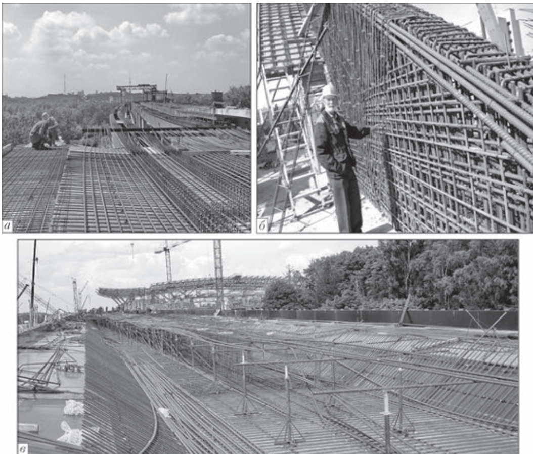
Рис. 4. Конструкции арматурных каркасов Подольского мостового перехода через р. Днепр (а), ригелей VIP-сектора НСК «Олимпийский» (б) и подъездной эстакады терминала D аэропорта «Борисполь» (в)
