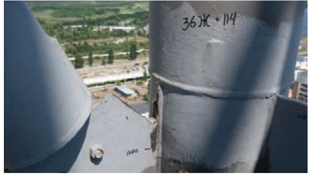
Рис. 3. Узел примыкания раскосов к стойке башни после вырезки темплета № 1
