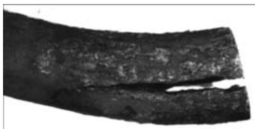
Рис. 3. Внешний вид поврежденного змеевика ПВД-8
