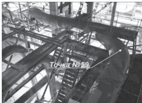
Рис. 19. Одна из точек измерения акустико-эмиссионной активности трубопровода промежуточного перегрева пара Киевской ТЭЦ-6
