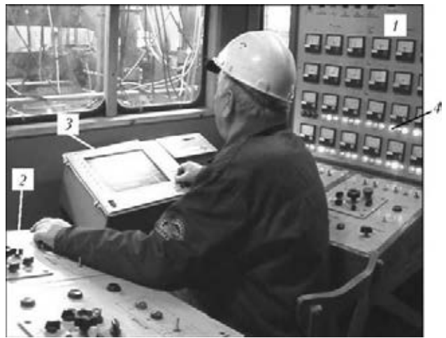
Рис. 3. Центральная кабина управления агрегатами установки: 1, 2 — соответственно пульты управления правым и левым блоком; 3 — промышленный компьютер PC670 системы мониторинга режимов сварки; 4 — сигнальные лампочки контроля движения сварочных проволок
