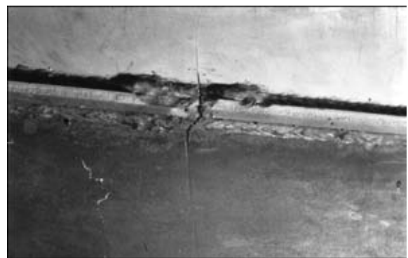
Рис. 5. Вид повреждения стыкового биметаллического шва при испытаниях на усталость крупномасштабной сталеалюминиевой конструкции
